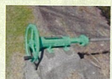
ゲート、バルブの更新
